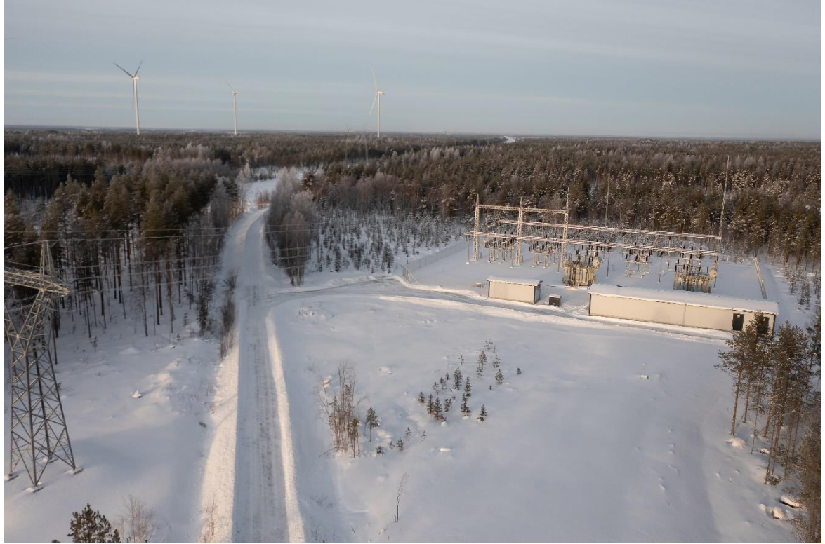
Kuva 1-4. Esimerkki tuulivoimahankkeen sähköasemasta (valokuva: Petteri Löppönen / OX2)
